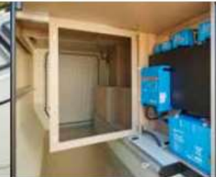
Garage m. Elektrozentrale
